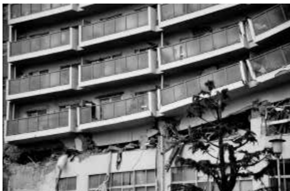
3 階施設(下階壁抜け柱：ピロティ)が圧壊したマンション
